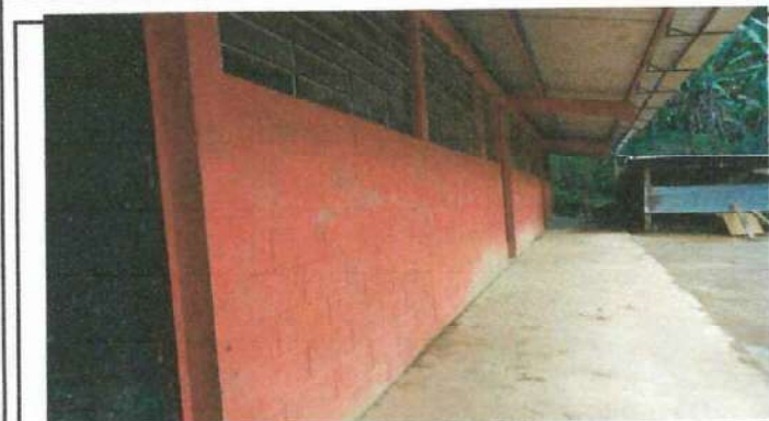
Foto 3: Paredes con necesidad de cerniado, pulido.
