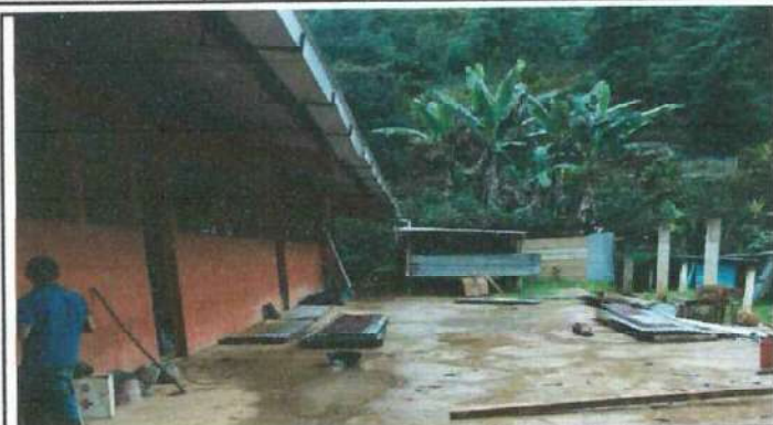
Foto1: Corredor del establecimietno con necesidad de entechado.
