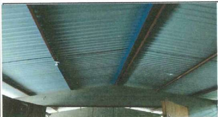
Foto 3: Estructura de techos con ncedidad de mantenimieto y pintura.
