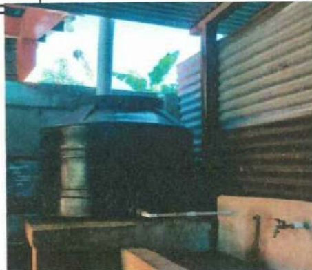
Foto 2: Compra de tinaco para ampliar la capacidad recolectora de agua.
