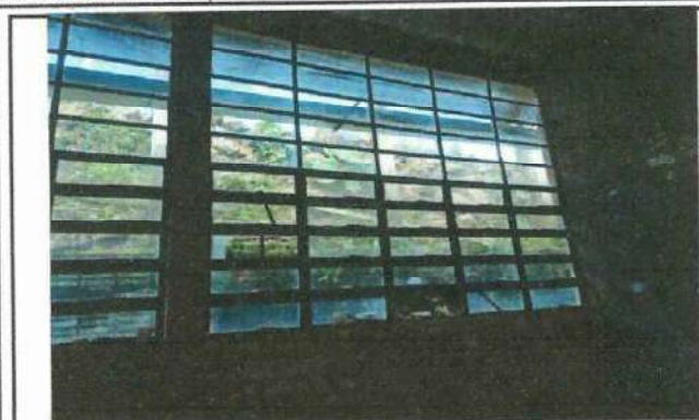
Foto 1: vidrios con necesidad de cambio y mantenimiento de estructura.
